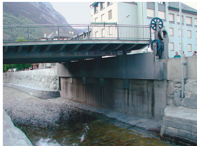
Saltina-Hubbrücke hochgezogen (wie bei einem Hochwasserereignis)
